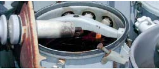
ความเป็นไปได้ในการใช้ co-processing: PBCs จากหม้อแปลงไฟฟ้า
